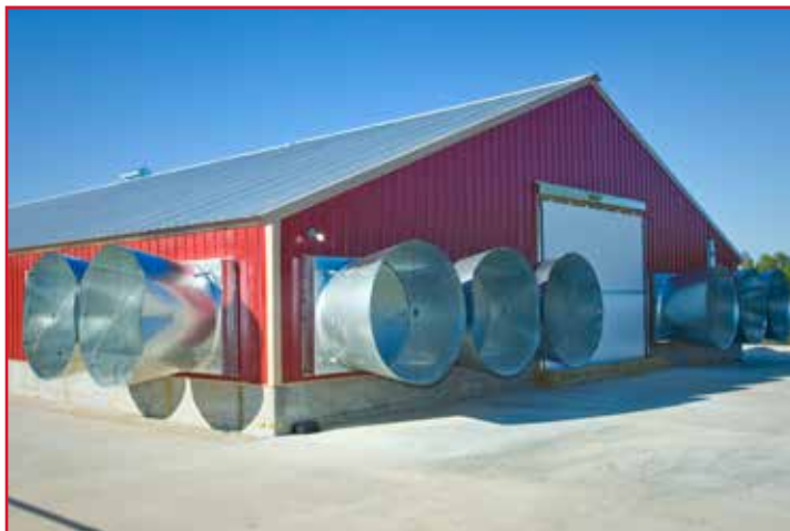
Figura 109: Ejemplo típico de un galpón con ventilación de túnel.
