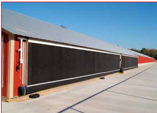
Figura 113: Ejemplo de un panel de enfriamiento.
