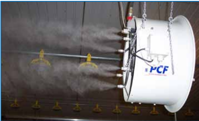
Figura 113: Ejemplo de un sistema de enfriamiento con aspersor.
