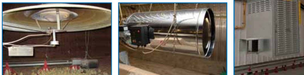
Figura 101: Ejemplos de diferentes sistemas de calefacción (de derecha a izquierda: pantalla de gas, calefacción para toda la nave, calentador portátil).
