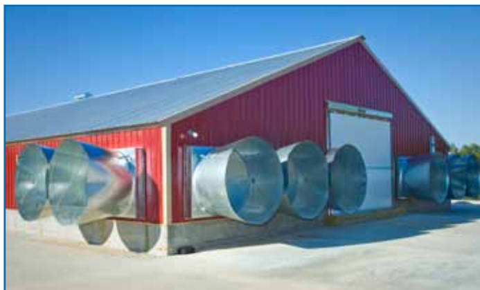
Figura 110: Ejemplo típico de una nave con ventilación de túnel.
