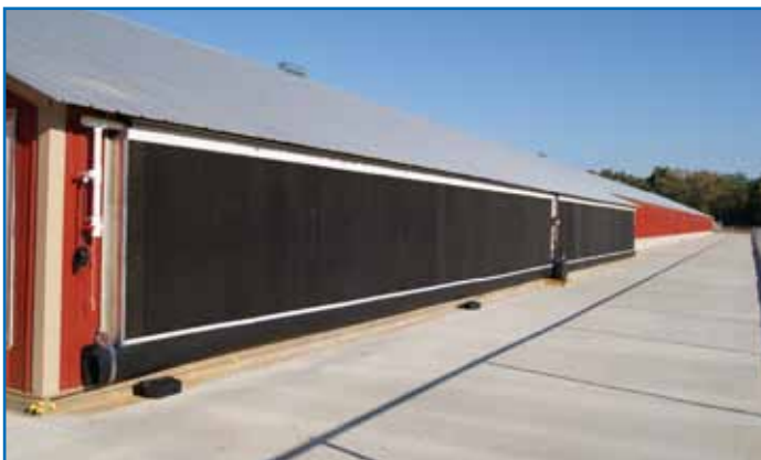
Figura 114: Ejemplo de un panel de enfriamiento.
