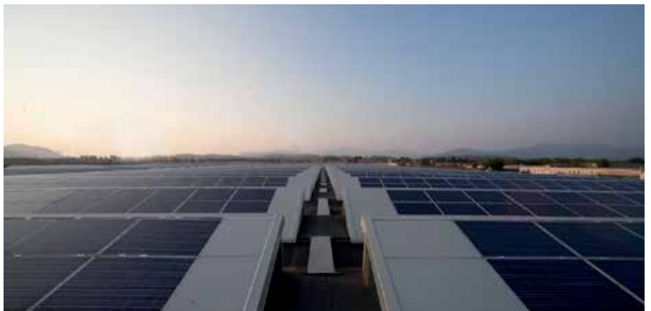
Cubierta fotovoltaica de la empresa
