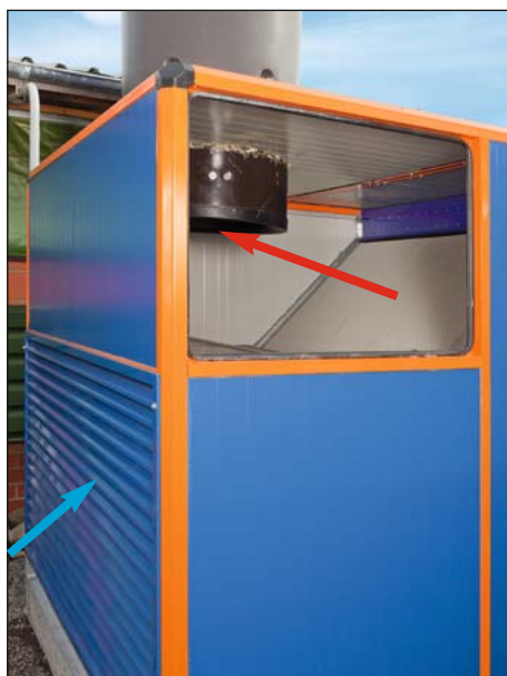
Entrada de aire fresco y aire de escape que se aspira del intercambiador de calor
