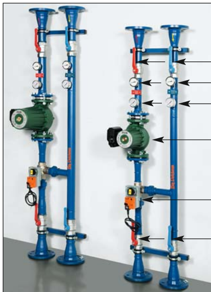
Regulación de calefacción 300 kW y 150 kW
