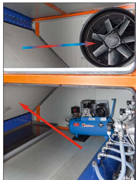
Se aspira el aire de escape limpiado (abajo) El aire fresco precalentado entra en la nave (arriba)
